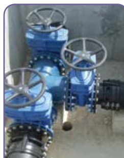
Centrale de Martigues, France, Marseille, AquaGrip
