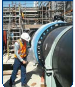
Usine de dessalement, Australie, grand diamètre
