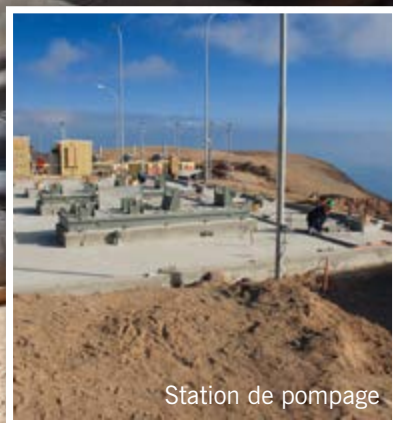
Installation à 52 bars
